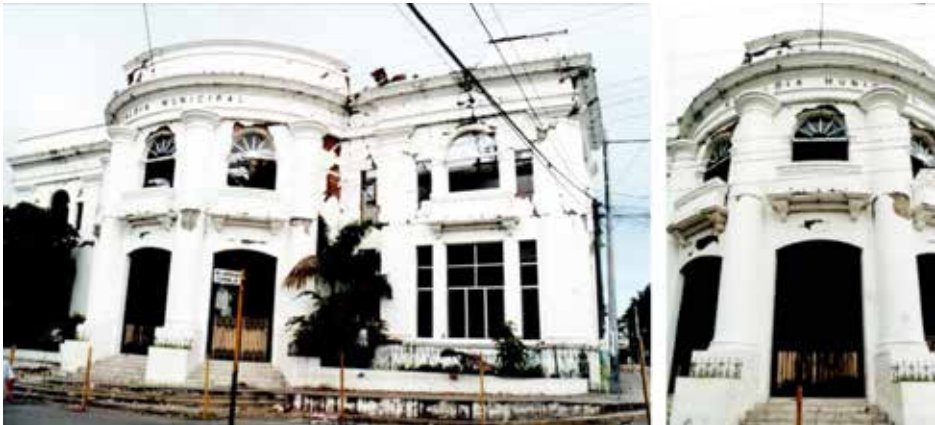
Figura 14. Estado del Palacio Municipal, daños causados por los terremotos de 2001. Junio de 2001 (CONCULTURA, 2001, Pág. 1).
