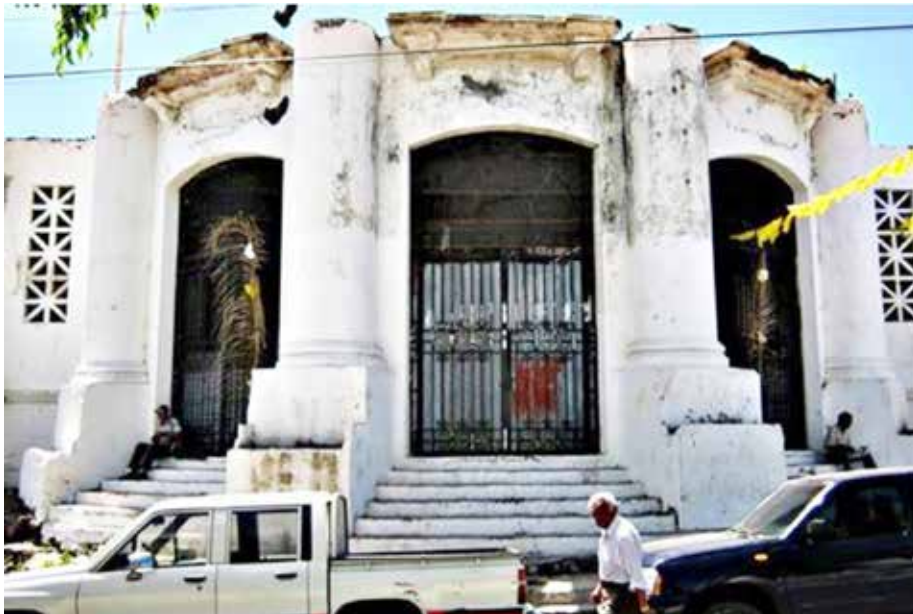
Figura 15. Estado del Palacio Municipal, Circa 2010 (Reminiscencias de El Salvador, 2019).
